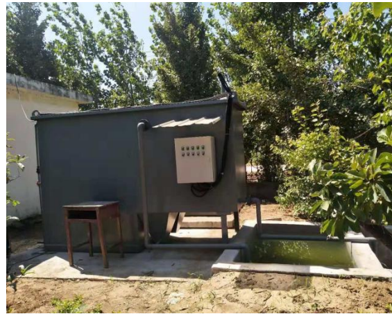
一体化处理设施
